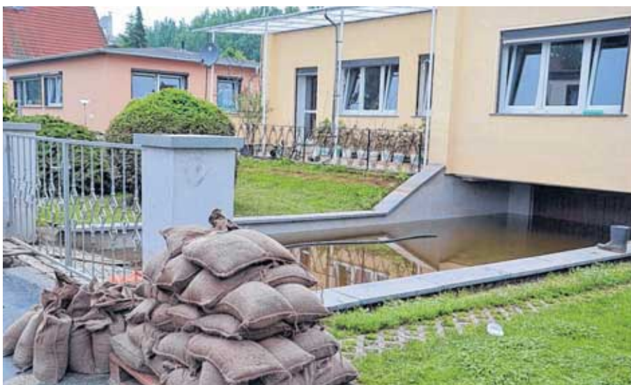
Ein betroffenes Haus in der Ratsziegelei: Bis zu den Fenstern der ersten Etage stand das Wasser, noch gestern reichte es in der Tiefgarage fast bis zur Decke. Foto: cc
